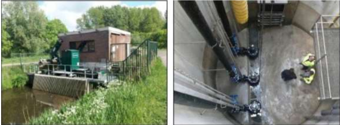
Figuur 39: Pompemaal in polder van Sinaai-Daknam. Bron: VVWP.
